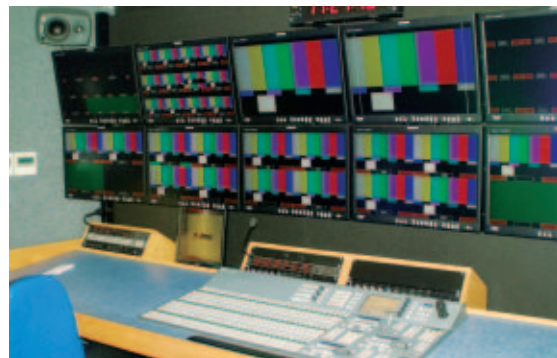
Режиссерский отсек ПТС канала «ТВ Центр»
